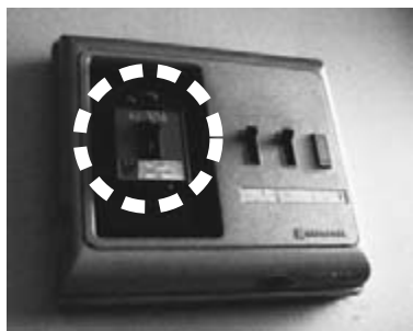
電気のブレーカー
