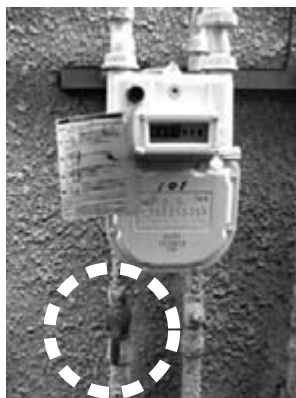
屋外のガスの元栓
